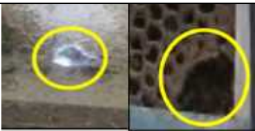
壁の穴やフェンスの破損部分
