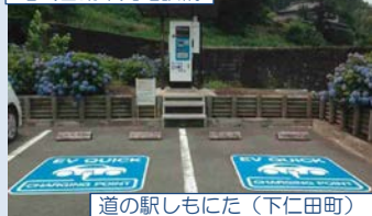
電気自動車充電設備
