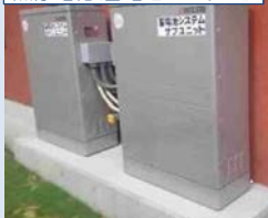
無停電化(蓄電池システム)
