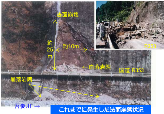
これまでに発生した法面崩落状況
