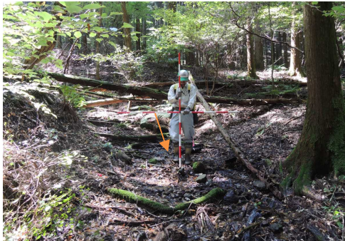
溪流の荒廃状況
