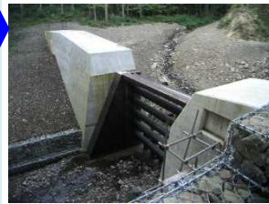
土石流発生前 (R01.9)
