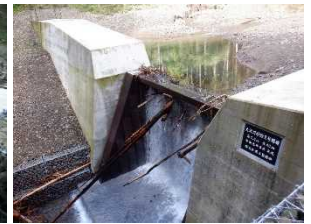
土石流発生直後 (R01.10.15)
