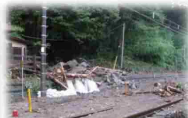
被災状況 (JR上越線)
